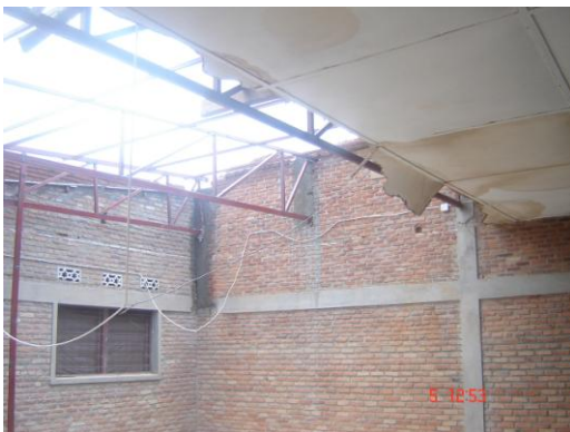
Toiture et plafond endommagés lors d'une pluie torrentielle en Janvier 2008
